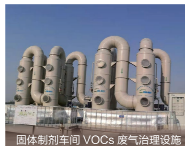
固体制剂车间VOCs废气治理设施
